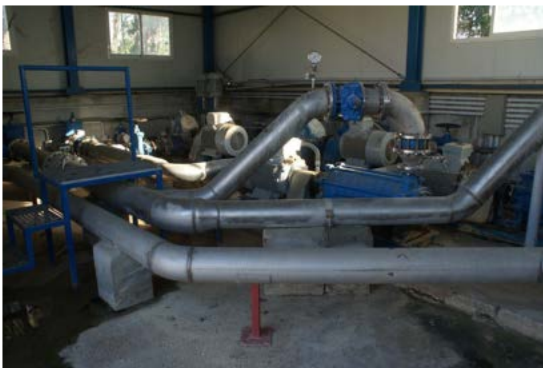
Figura 28. Fotografía del sistema de bombeo. (Fuente: autor)
